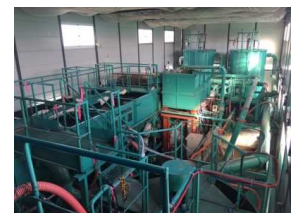
濁水処理設備
