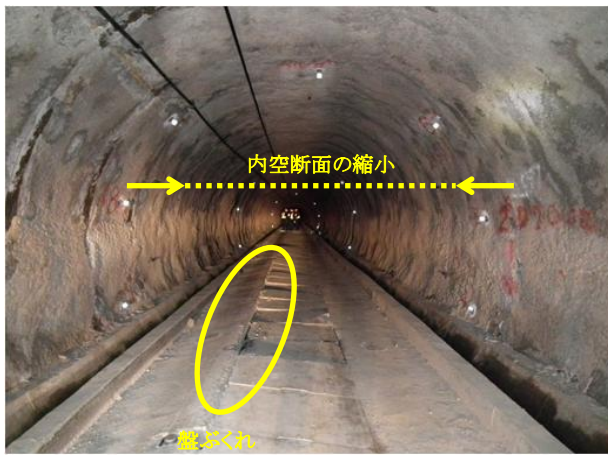
写真-1 吉岡先進導坑(2k070m 付近)付近 の盤ぶくれ発生状況
