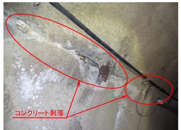
写真-2 コンクリート剥落箇所 (吉岡先進導坑(2k070m) 付近)
