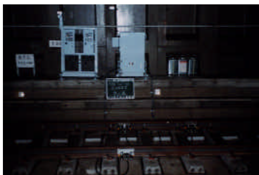
写真 7-4-6 自動レール塗油器
