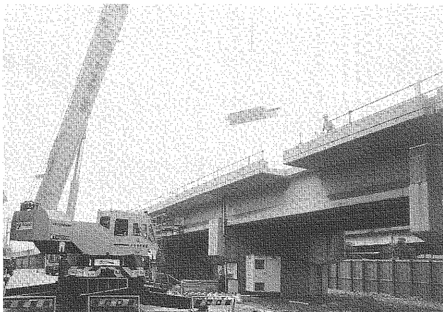
写真 3-7-4 切断したスラブのてっ去
