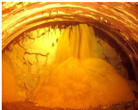
NATMで施工中のトンネル掘削面の崩壊 複雑な地質や地下水位が原因で、 三本木原トンネルでは崩落が起きた。
