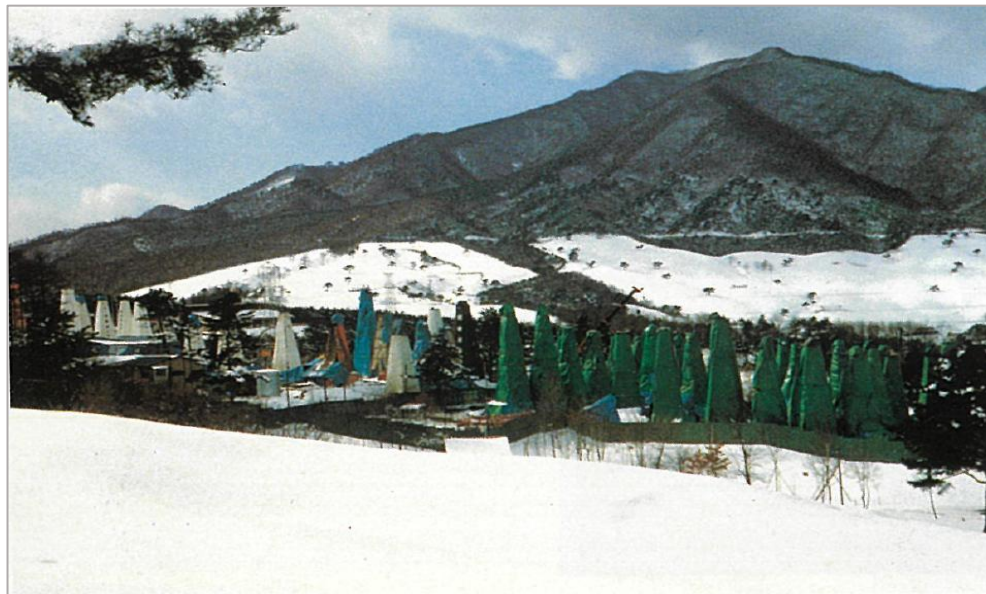
地表からの薬液注入。柱状の施工機械で薬液を注入して地盤を安定させた。
