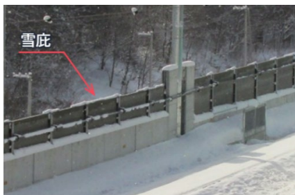
写真-3 防音壁天端の雪庇の形成状況
