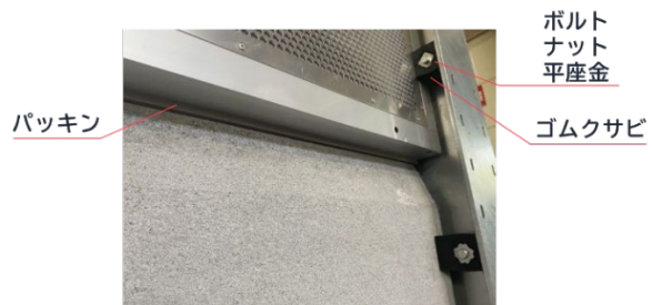
写真-7 試験後の部材の状況
