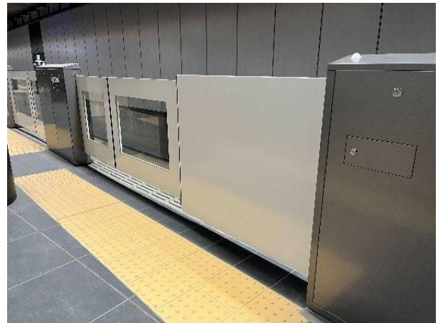
図-6 多段式可動柵（新横浜駅）
