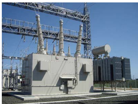
写真－4 東北新幹線 新七戸変電所 ルーフデルタ結線変圧器
