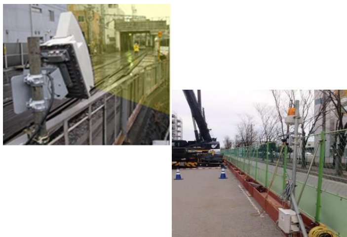
写真 5-11 レーザーバリア(空中越境監視装置)
