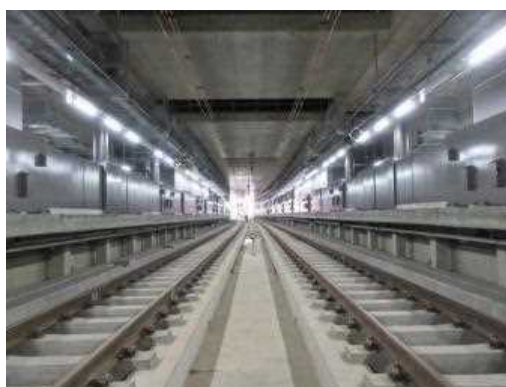
写真 1.1.2-1 羽沢横浜国大駅のホーム階の照明設備の設置状況
