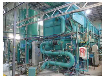
▲濁水処理設備
