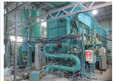
▲濁水処理設備
