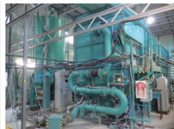
▲濁水処理設備
