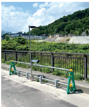
街灯ソーラーパネル
