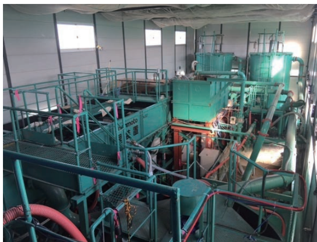
濁水処理設備
