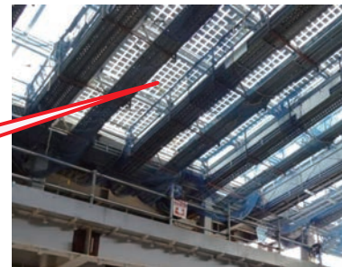
下北沢駅における自然採光と太陽光パネル（小田急電鉄㈱提供）
