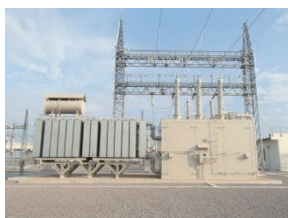
ルーフ・デルタ結線変圧器 新函館変電所
