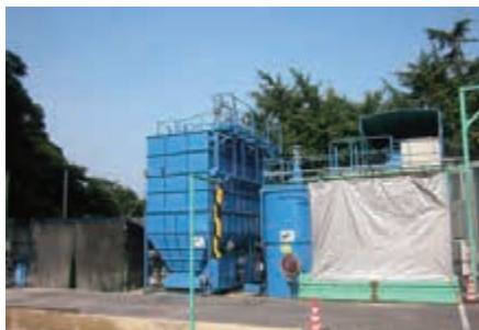
濁水処理設備
