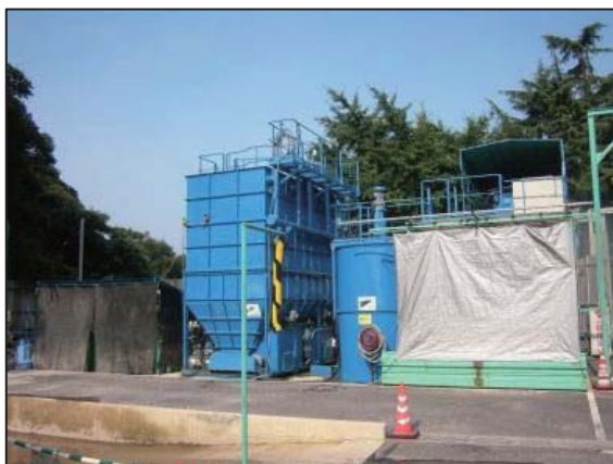
濁水処理設備
