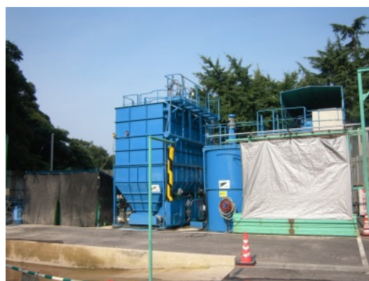
濁水処理設備
