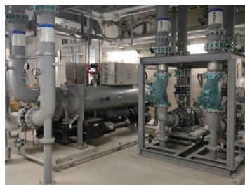
地下駅の空調（相鉄・東急直通線）
