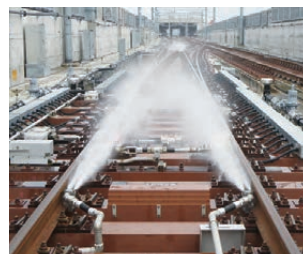
分岐器急速除雪装置（北陸新幹線）
