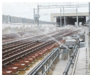
散水消雪設備（北陸新幹線）
