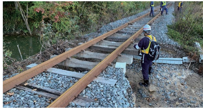
路盤流出に係る被害状況の調査
