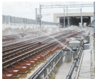
散水消雪設備（北陸新幹線）
