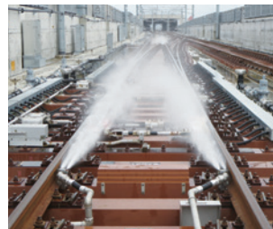
分岐器急速除雪装置（北陸新幹線）
