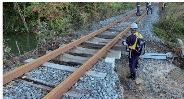
路盤流出に係る被害状況の調査
