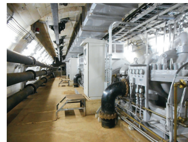
トンネル湧水を排水するポンプ
