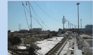
復旧前：電気施設・防音壁等倒壊
