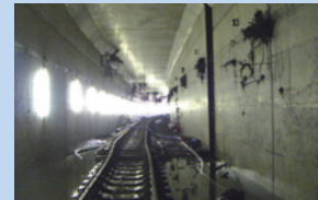
復旧前：軌道変位、継手部目違
