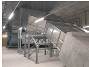
トンネル用の換気・排煙設備（相鉄・東急直通線）
