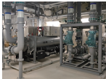
地下駅の空調（相鉄・東急直通線）
