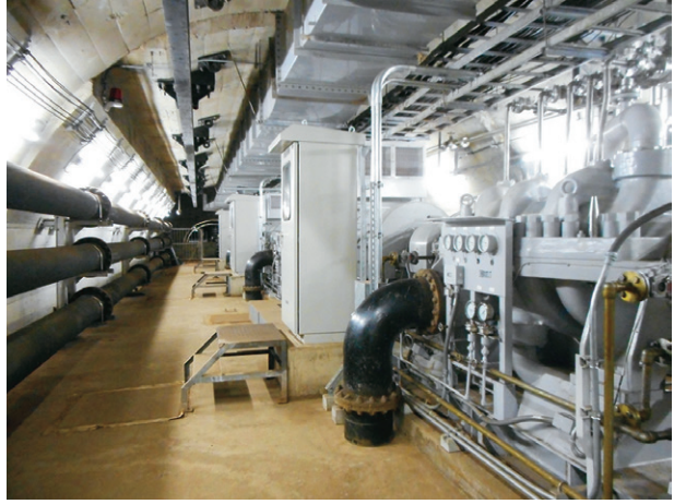
トンネル湧水を排水するポンプ
