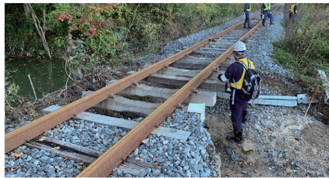
路盤流出に係る被害状況の調査
