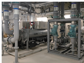
地下駅の空調（相鉄・東急直通線）
