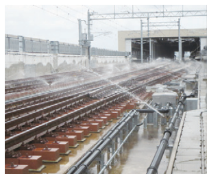
散水消雪設備（北陸新幹線）
