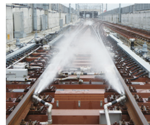
分岐器急速除雪装置（北陸新幹線）
