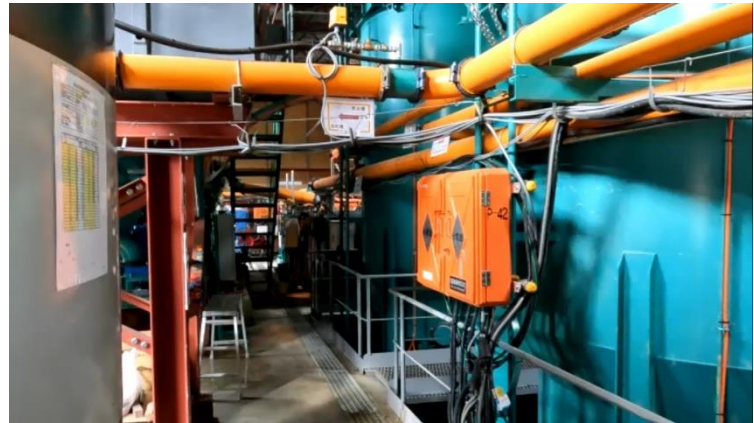
【濁水処理施設】
