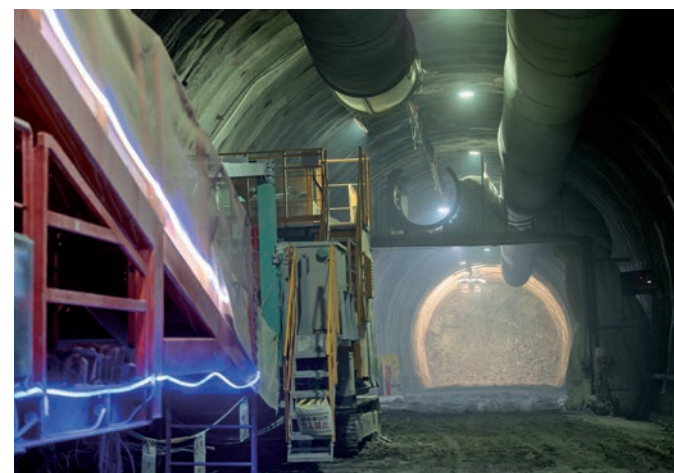
換気により粉塵が吸まってくる
