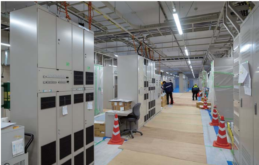
多数の機器が設置されている通信機器室。地震対策なども入念に施されている
