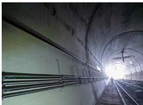
トンネルの壁面には各種ケーブルが設置されている。今後、電源ケーブルが上の金具位置に設置される
