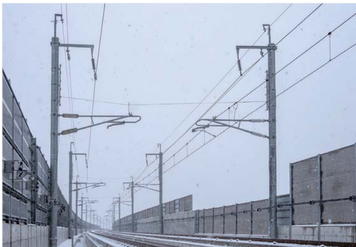
鋼管柱の中ほどから伸びる三角のアームが可動ブラケット。先端にちょう架線が取り付けられ、その下にパンタグラフと接するトロリ線がある
