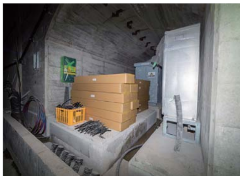
500mごとに設置されている器材坑。保守時の待避所にもなる。器材坑には沿線電話、トンネル内の電源供給用電源設備、信号ボックスなどが設置されている
