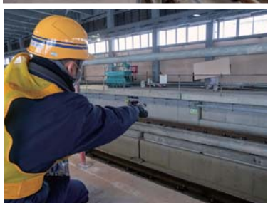
ホーム下の配線について説明する佐々木大輔所長。各種ケーブルは複数段のラックに収められている
