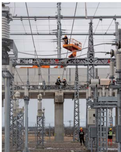
新加賀き電区分所へATき電線を接続する。新幹線の安定輸送に欠かせない設備だ
