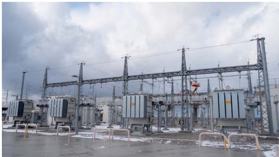
変電所からの電気が切り替わる地点にあり、巨大なスイッチの役割を果たす新加賀き電区分所
