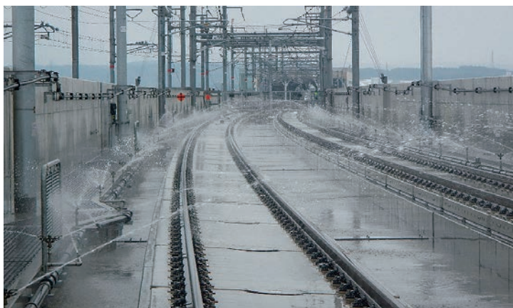
散水消雪方式（散水状況）
