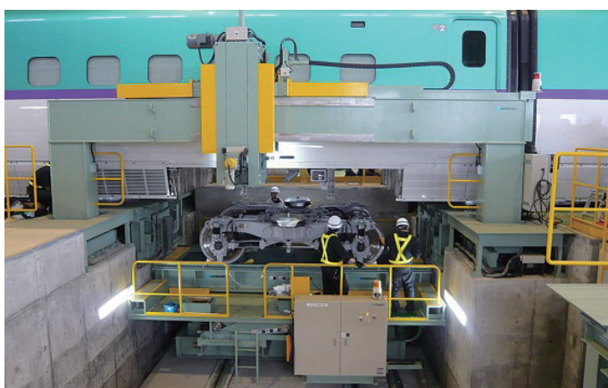
台車取扱装置
