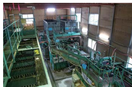
各工区には濁水処理施設があり、掘削によって発生した湧水を浄化処理したうえで、河川に戻している。写真は昆布トンネル宮田工区の濁水処理施設
