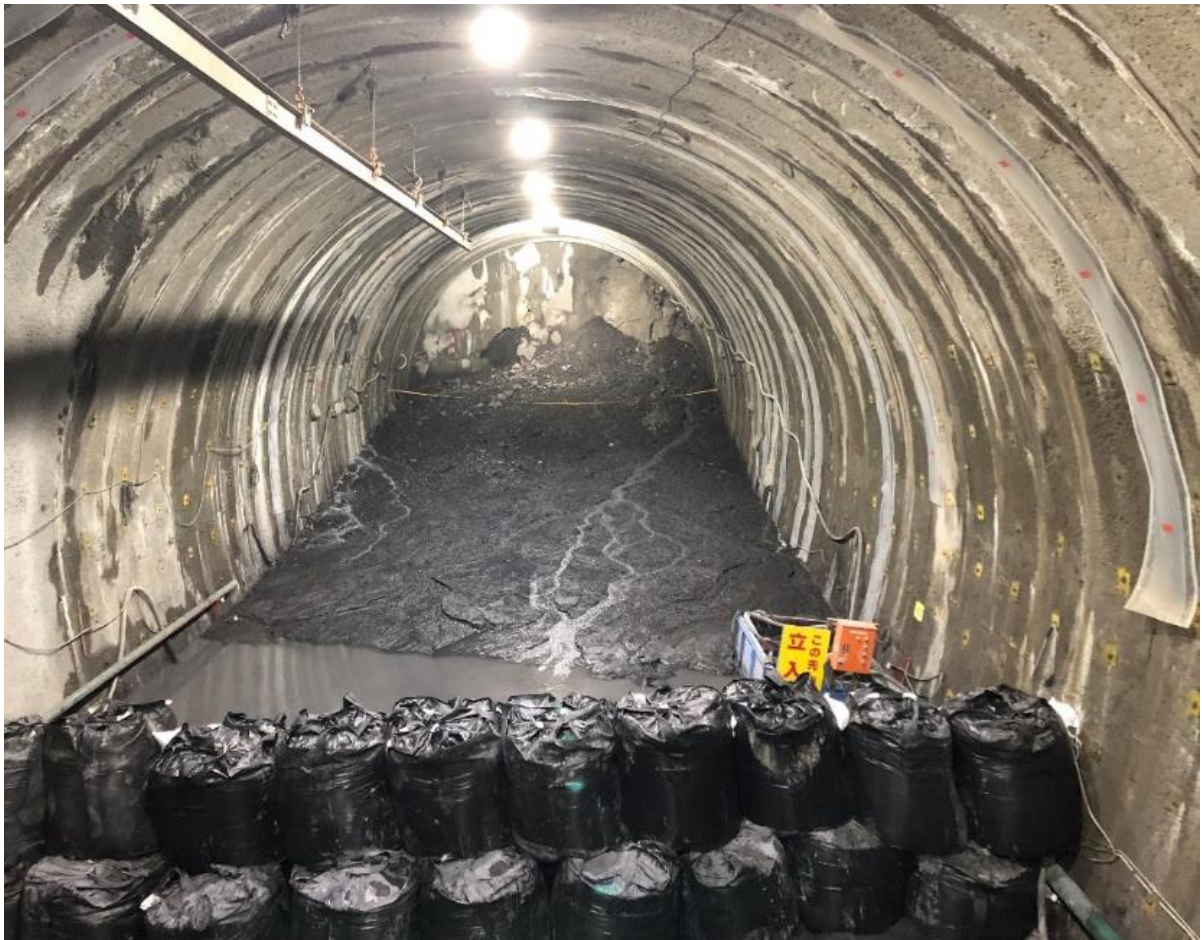
トンネル坑内の状況（令和4年 3月22日（火） 午前8時頃） 新函館北斗方から札幌方を撮影
