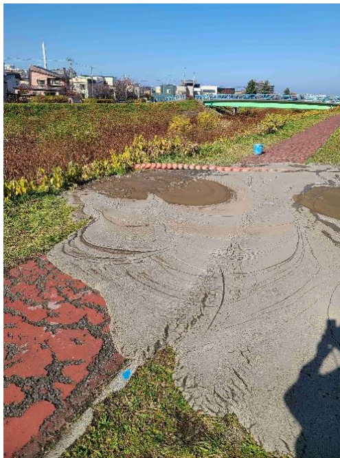
泥土等漏出時の様子(地表面) (11時50分頃)
