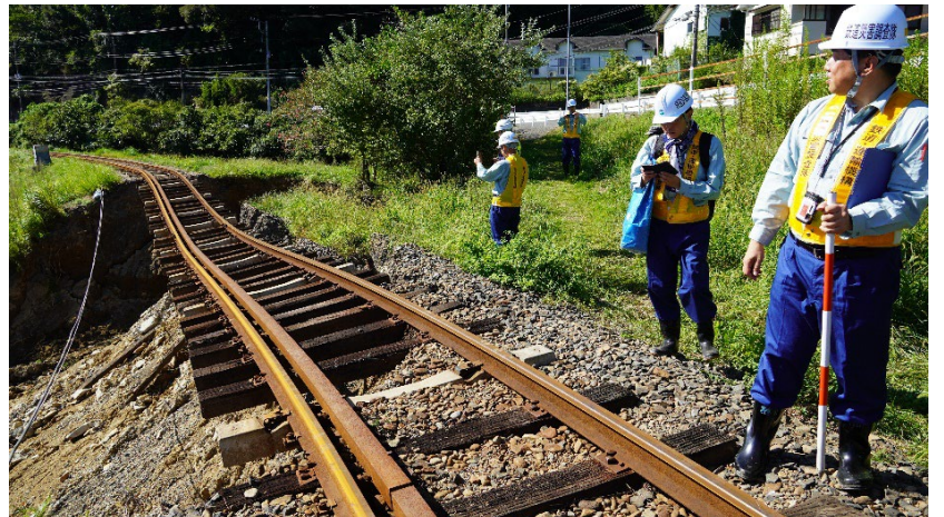
<西畑駅～上総中野駅間> 路盤流出箇所への調査
