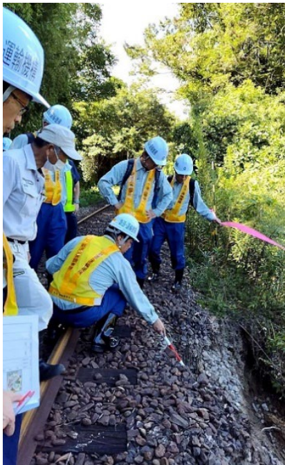
<総元駅～西畑駅間> 路盤流出箇所への調査
