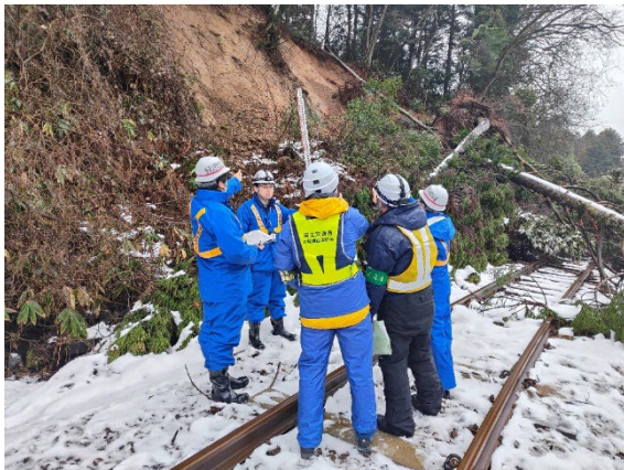
< のと 能登鹿島駅～ あなみず 穴水駅間> 土砂流入箇所の調査
