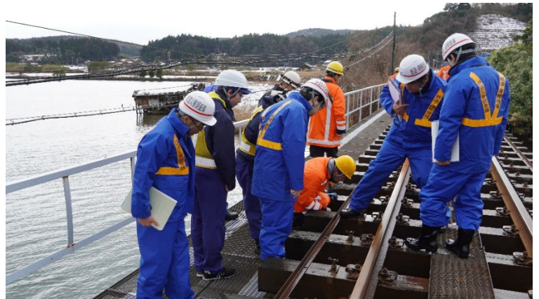
< たつるはま 田鶴浜駅～ かざしほ 笠志保駅間> 橋りょう被災箇所の調査
