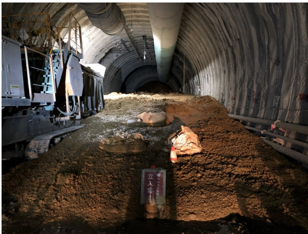
トンネル坑内の状況（2021年3月22日6時頃）
