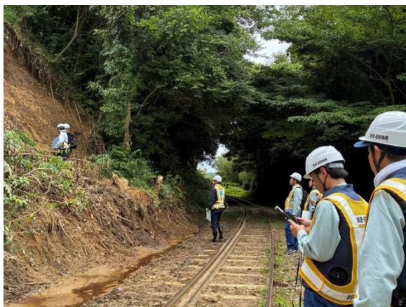
土砂流入箇所の調査
