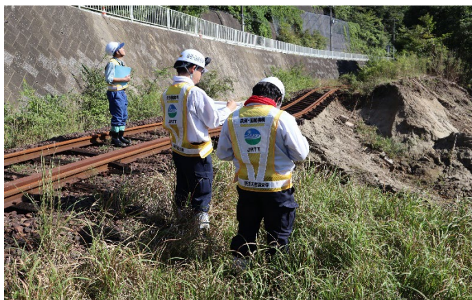
路盤流出箇所の調査
