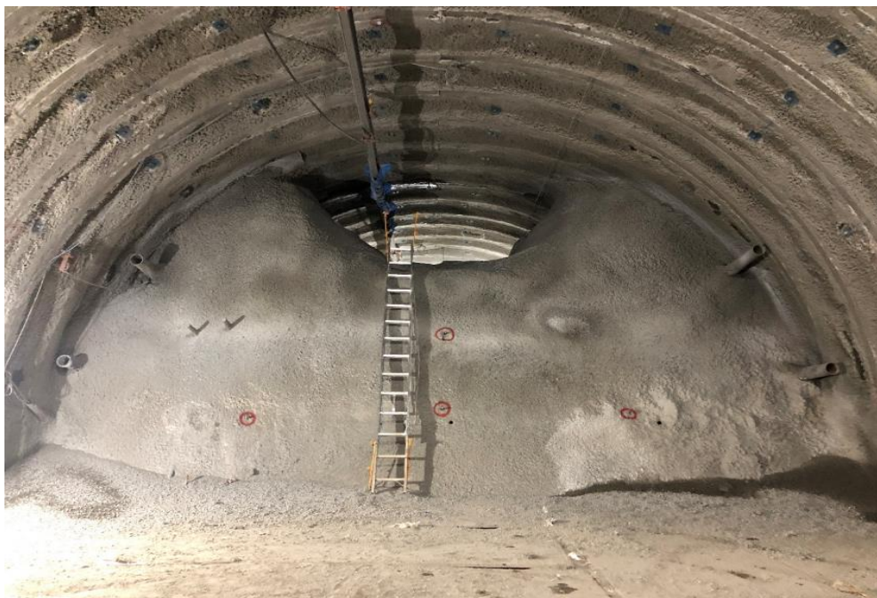
トンネル坑内の状況 (2021年3月26日7時頃) (土のうを積み上げ、コンクリートを吹き付けたせき止め措置)
