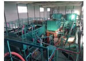
濁水処理設備
