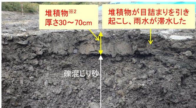
堰堤(既設)付近の滞水箇所底部の状況 (R3.9.28 滞水撤去後に撮影)
