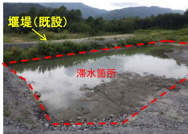
滞水の状況 (R3.9.7 撮影)
