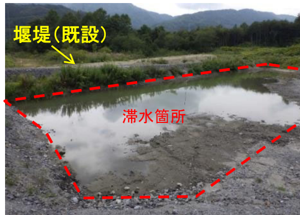
滞水の状況(R3.9.7撮影)
