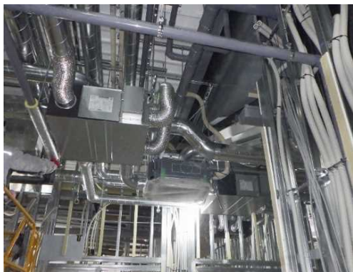
▲駅事務室の空調設備
