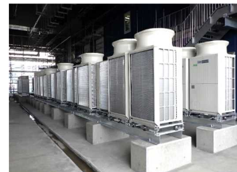
2階室外機置場の空調設備▶
