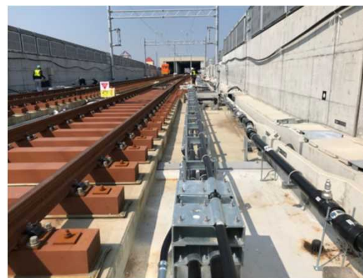
▲西部消雪基地 高架上配管
