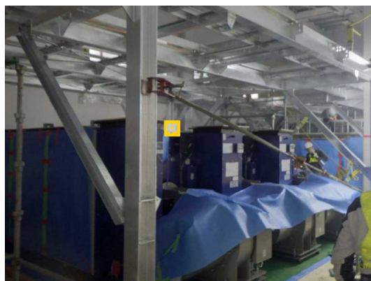
▲西部消雪基地 加熱機室
