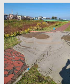
泥土等漏出時の様子（地表面）
