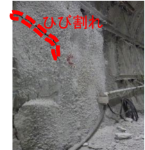
吹付けコンクリートのひび割れ
