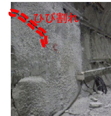
吹付けコンクリートのひび割れ
