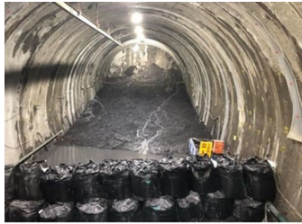
トンネル坑内土砂流入状況
