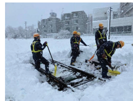
除雪に必要な修繕
