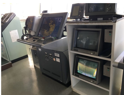
ブリッジ(船舶を操縦する場所)を見学させていただきました
