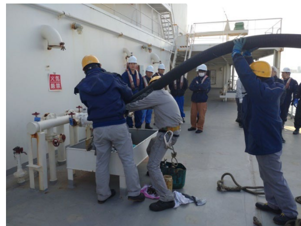
燃料供給管の本船への接続
