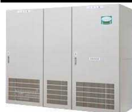
非常用発電機
