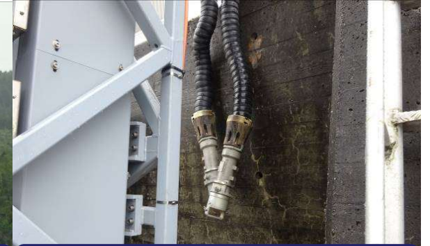
旧(現状) 給電設備
