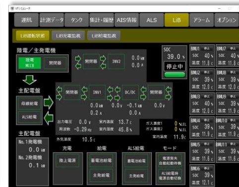
バッテリーモニタリング
