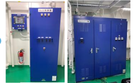
制御盤&インバータ盤 空気潤滑システム用
