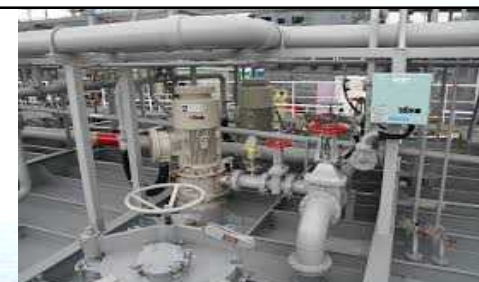
電動ディープウェルポンプの作動装置
